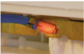
Brandgefahr droht bei der Überbeanspruchung von Stromkabeln
