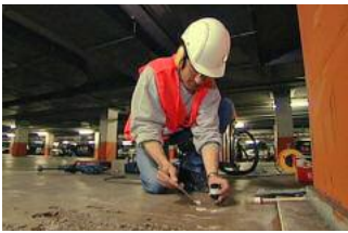
Um zu überprüfen, ob die Tiefgarage noch sicher ist, müssen Proben entnommen werden
