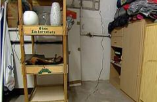
Bergschäden verursachen Schieflagen von Häusern und Risse in den Wänden
