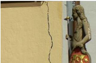
Risse in den Häusern der Altstadt
