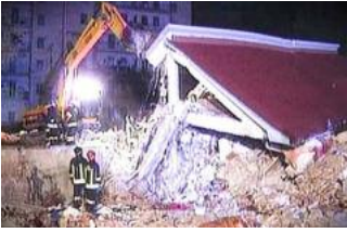
Das Beben beschädigte und zerstörte fast eine halbe Millionen Häuser
