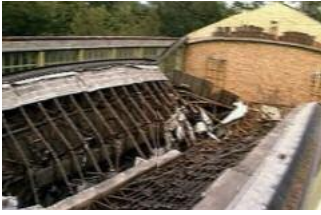
Beim Einsturz dieser Turnhalle im Münsterland konnten sich die Kinder rechtzeitig retten
