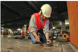
Um zu überprüfen, ob die Tiefgarage noch sicher ist, müssen Proben entnommen werden
