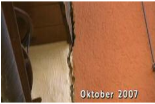
Risse in den Häusern der Altstadt
