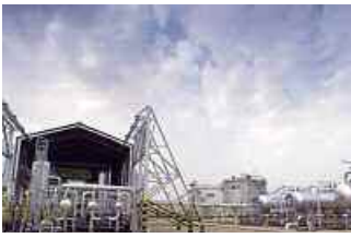
Öl-Aufbereitungsanlage in Al-Ahmadi/ Kuwait
